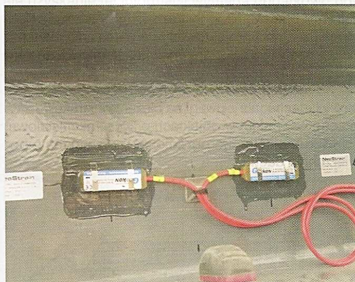
Rys. 6. Przykład czujników zamontowanych do elementu kratownicy po odtworzeniu powłok malarskich na konstrukcji
